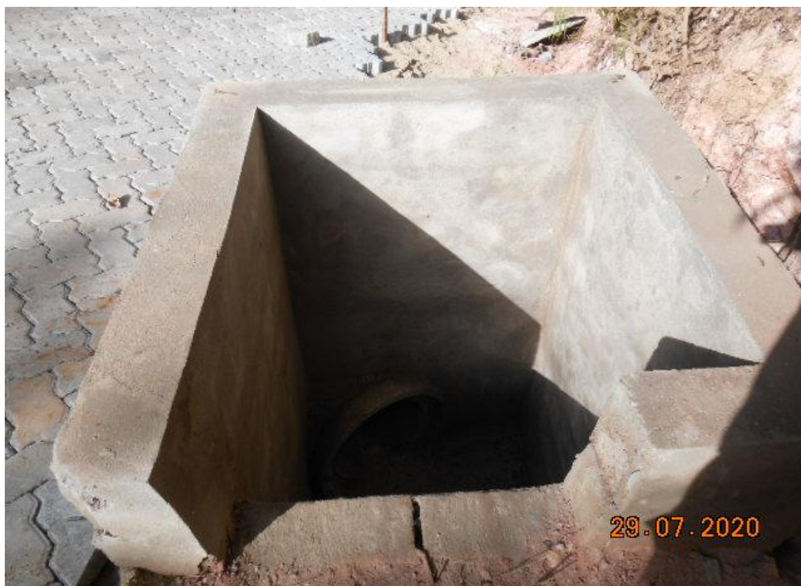
Foto 11 – Vista da rede pluvial da rua do Taquaral
